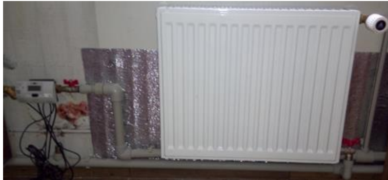
Рис.2. Фрагмент установки квартирнього лічильника тепла, нового нагрівального приладу і регулятора температури «Danfoss»
