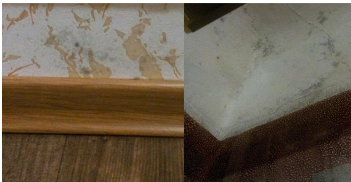
Рис. 2. Осередки грибкового ураження конструкцій будівлі
