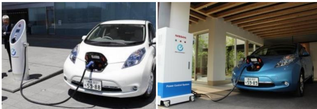
Рис. 2. Зарядні станції для електромобілів
