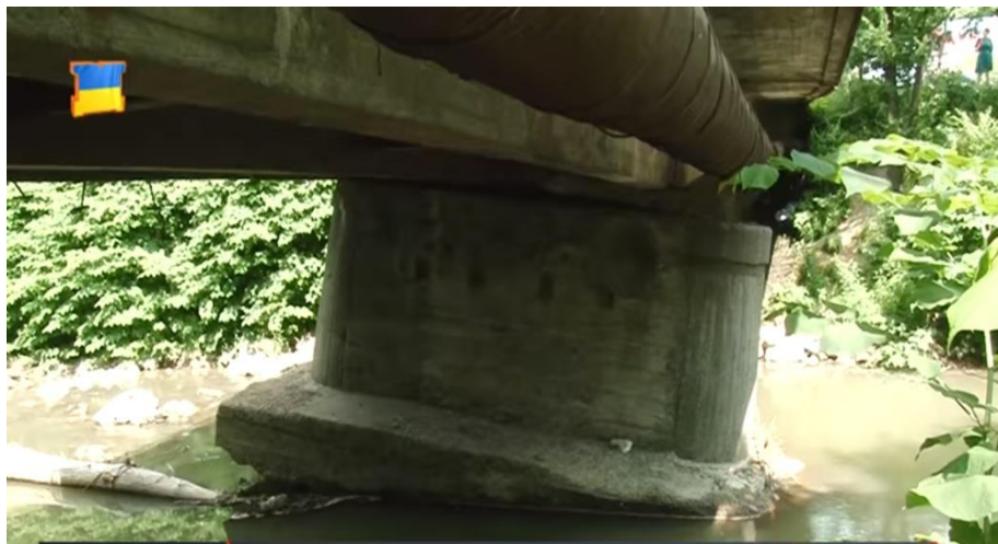
Рис.1. Підмив опору мосту у м. Свалява, 2016 р
